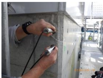
ひび割れ深さ測定
