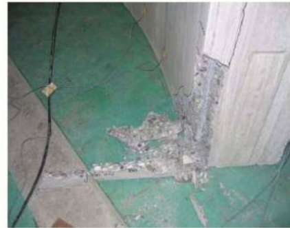
通常セグメント端部の破壊時の状況 (ひび割れ発生後にコンクリート片が崩落する)
